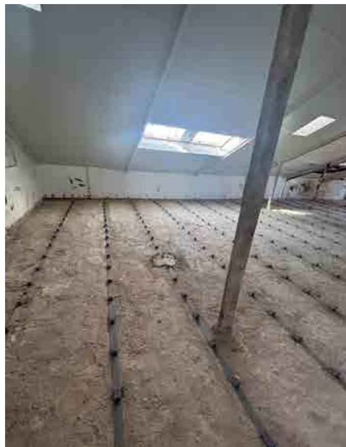
Instalación de los Conectores Acero CentroStorico Soldados a las vigas metálicas existentes del forjado.
